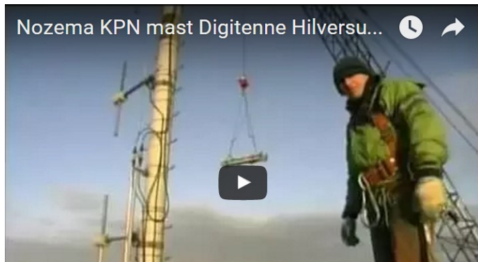
De bouw van de nieuwe installatie (Klik op de afbeelding voor het filmpje).
