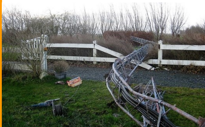
Staat je mast nog na de storm? Dan zaten er te weinig antennes in! Is het bovenstaande het gevolg? Dan moet je gaan bouwen met passie!
