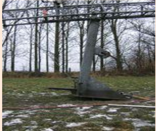
Duidelijk is te zien dat de voet van de antennemast niet meer vlak op de grond staat.
