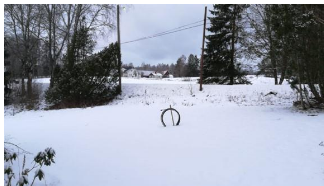
Mooi wit !! De kabelrol in de tuin is de voorbereiding voor de glasvezelaansluiting.
